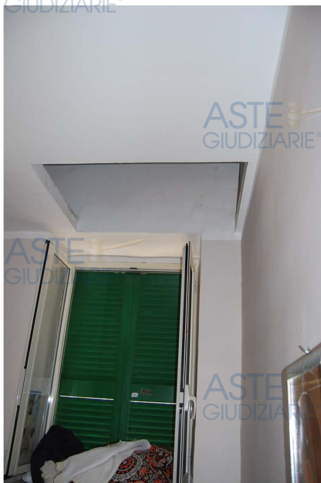
FOTO 16 PARTICOLARE BOTOLA SOPP./DEP. LETTO U. IMMOBILIARE PORZIONE 2
