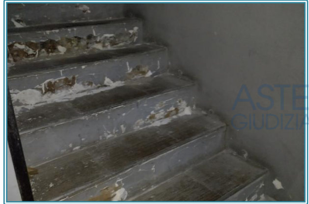
Figura 27 Particolare stato di conservazione della scala
