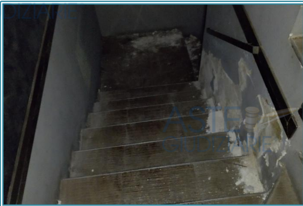
Figura 28 Particolare stato di conservazione della scala
