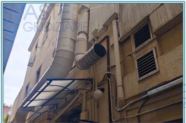
Figura 13 Particolare dell'impianto di areazione sulla facciata del fabbricato
