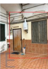
Foto n. 10 - Ballatoio - ingresso all'immobile
