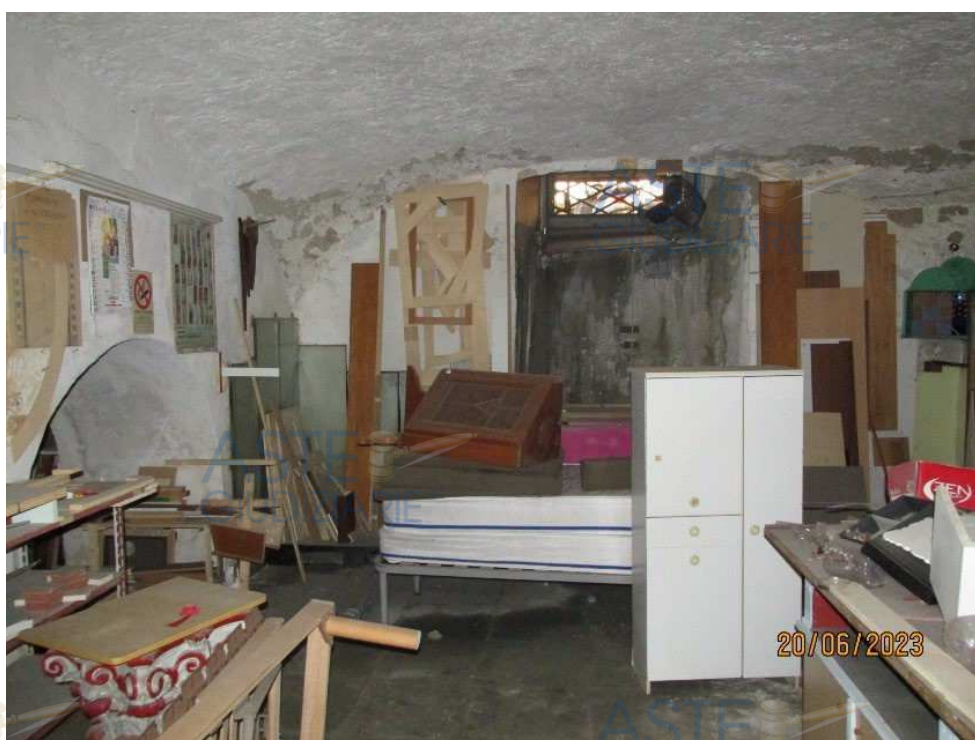
Fotografia 22 – Locale 2: L'ambiente dispone di una lustriera a “bocca di lupo” prospiciente la strada pubblica di Vico Sant'Eframo Vecchio. L'ambiente si presenta in un totale stato di abbandono, occupato da diversi mobili e materiali di ogni genere, le pareti mostrano segni diffusi di efflorescenze di macchia di umidità da risalita, anche il soffitto presenta diffuse macchie di umidità con fenomeni di distacco dello strato superficiale degli intonaci.
