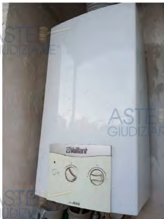
Foto n.17 – balcone n.2 – scaldacqua a gas
