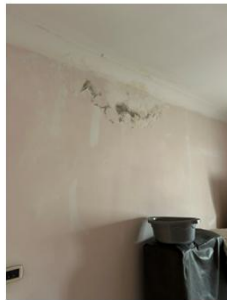
Foto n. 38 - Camera n.1 - particolare delle macchie da infiltrazione
