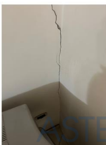
Foto n. 56 - Camera n.2 - particolare delle lesioni
