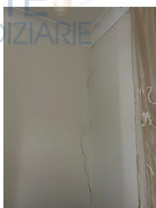
Foto n. 54 - Camera n.2 - particolare delle lesioni
