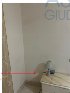
Foto n. 52 - Camera n.2 - particolare delle lesioni
