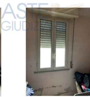
Foto n. 39 - Camera n.1 - particolare delle macchie da infiltrazione
