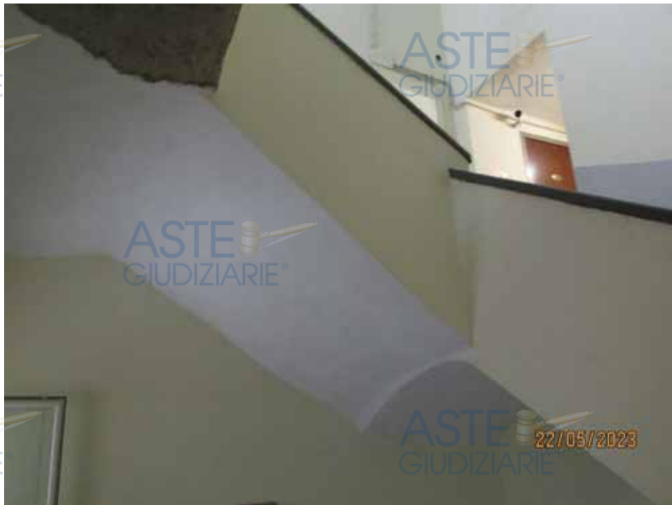
Fotografia 17 – La struttura della scala è costituita in muratura portante protetta esternamente da un muretto sprovvisto di corrimano.
