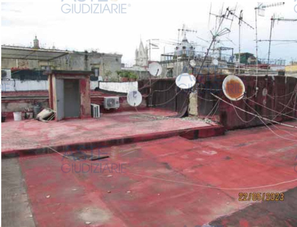
Fotografia 56 – Lastrico Solare: Il Lastrico Solare occupa una superficie utile calpestabile pari a mq. 76,64 e risulta interamente pavimentato con guaina bituminosa, tinteggiata con vernice acrilica protettiva.
