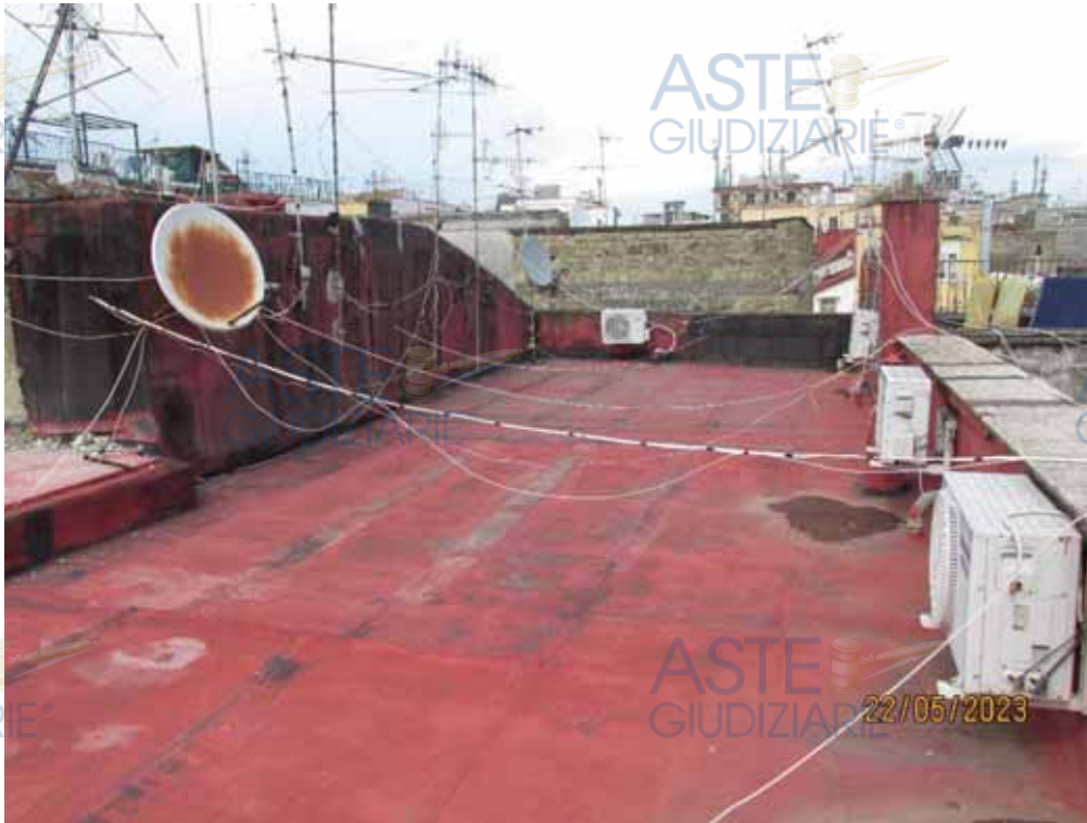
Fotografia 57 – Lastrico Solare: Sui confini esterni sono presenti muretti di diverse altezze che fanno da recinzione verso il vuoto e sono utilizzati per sorreggere antenne e pompe di calore a servizio delle unità immobiliari che insistono nel fabbricato; infatti, sul Lastrico Solare ci sono numerosi cavi in attraversamenti aereo.
