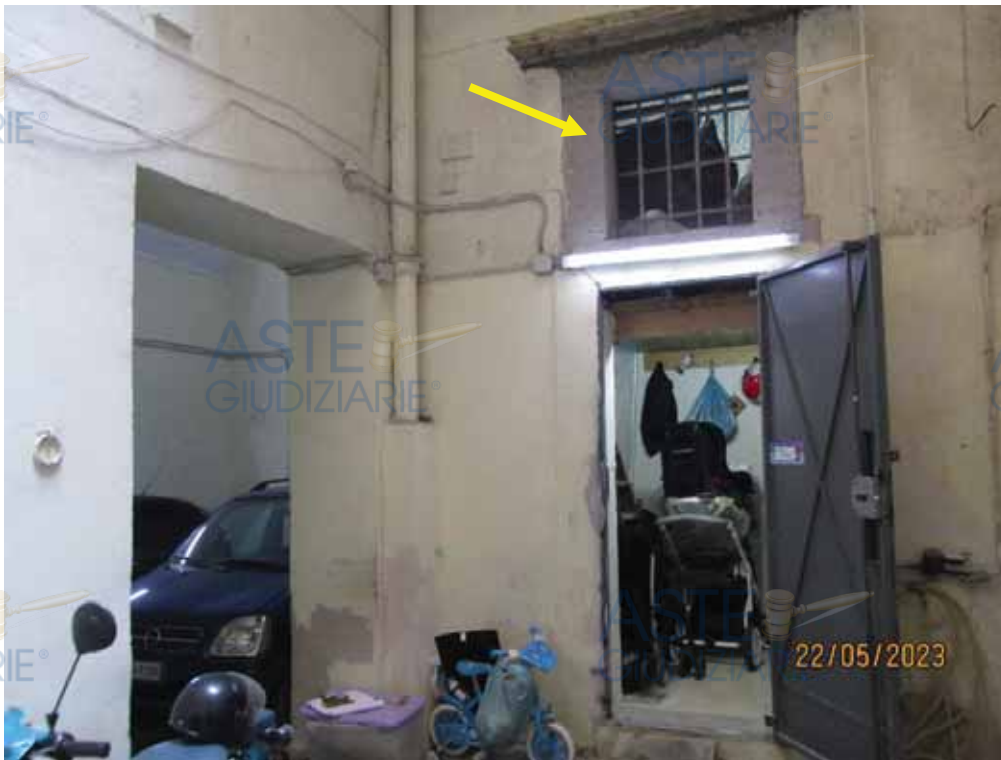
Fotografia 51 – Locale Deposito: Il locale è dotato di una finestra protetta con grate in ferro posta sopra la porta d'ingresso.
