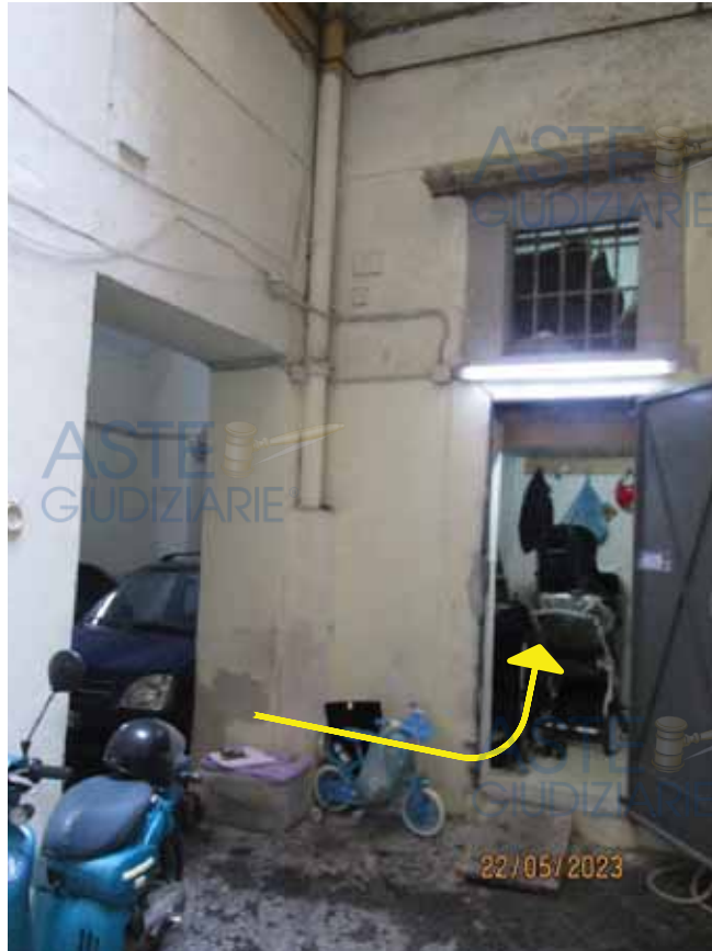
Fotografia 48 – Locale Deposito: Vi si accede dalla corte condominiale del fabbricato, il primo a sinistra per chi entra in detta corte dal Vico dei Maiorani, il piano di calpestio del locale deposito si trova a circa cm. 25,00 di altezza rispetto al piano di calpestio del cortile condominiale. Occupa una superficie utile netta pari a mq. 5,69 e un’altezza di ml. 5,40, risulta protetto esternamente da un serramento in ferro con serratura blindata. La pavimentazione è costituita per tutta la superficie da piastrelle in ceramica smaltata.
