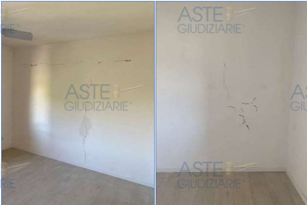
Figura 14. Particolare delle lesioni rinvenute sui tramezzi al piano primo.
