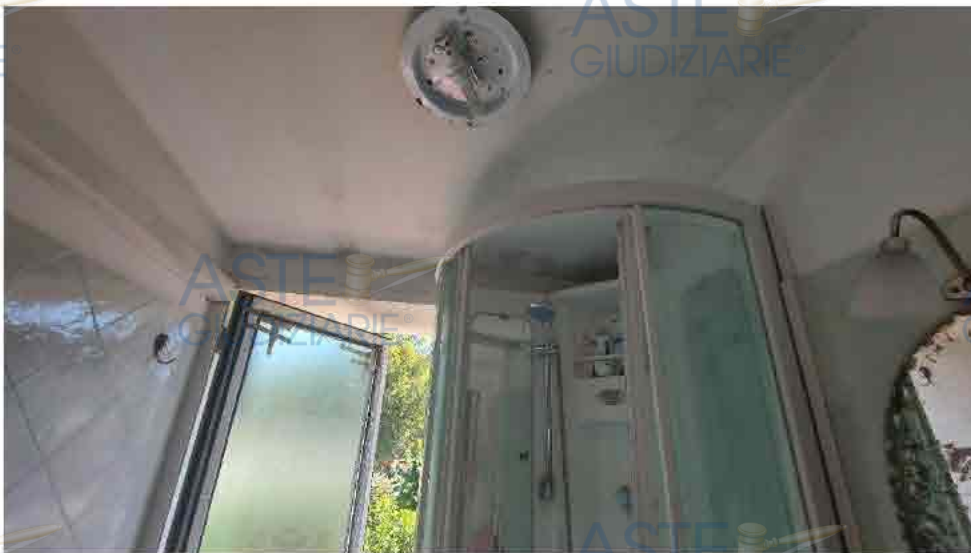
Tracce infiltrazioni soffitto bagno wc 2
