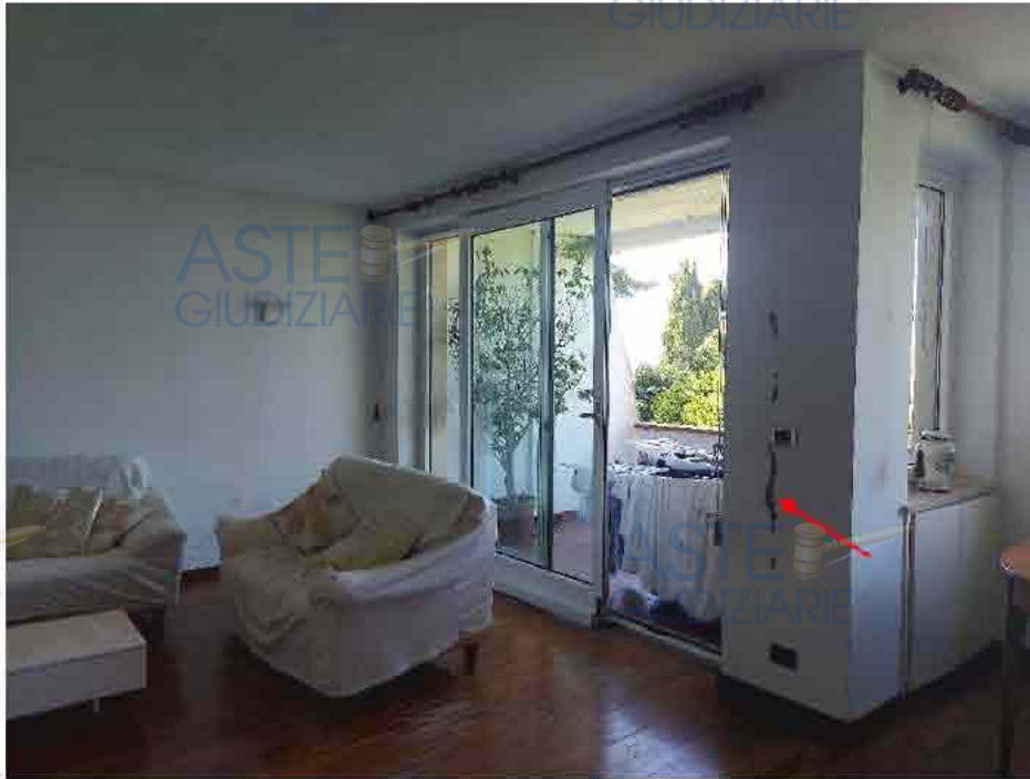
Particolare - lesione su muratura perimetrale salone
