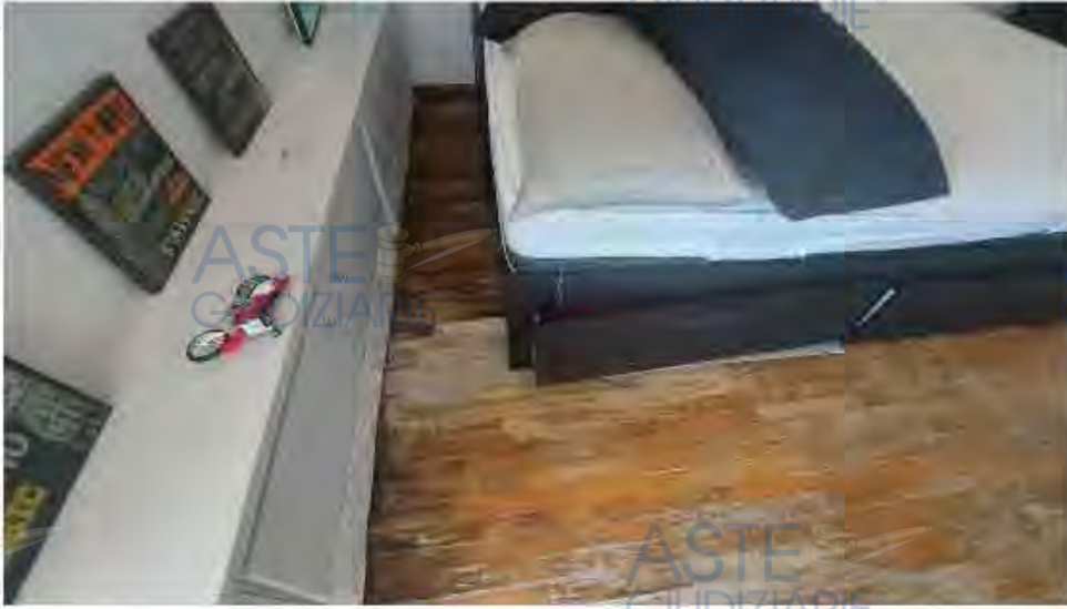
Particolare - danni infiltrazioni pavimentazione camera L3
