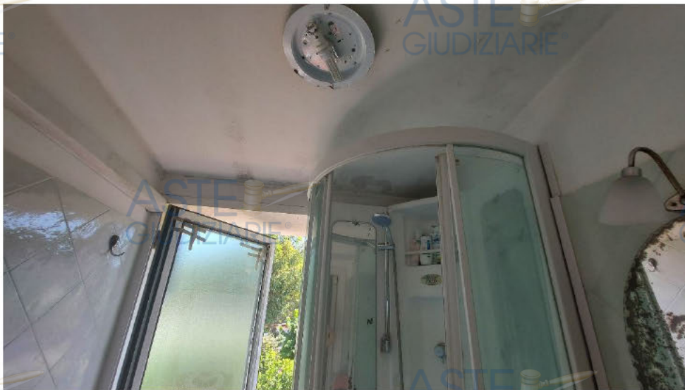
Tracce infiltrazioni soffitto bagno wc 2
