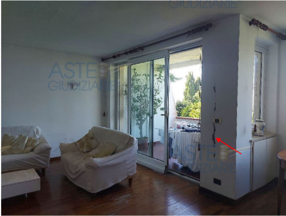
Particolare - lesione su muratura perimetrale salone
