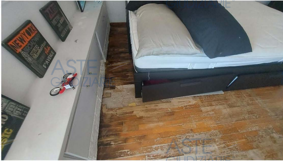
Particolare - danni infiltrazioni pavimentazione camera L3
