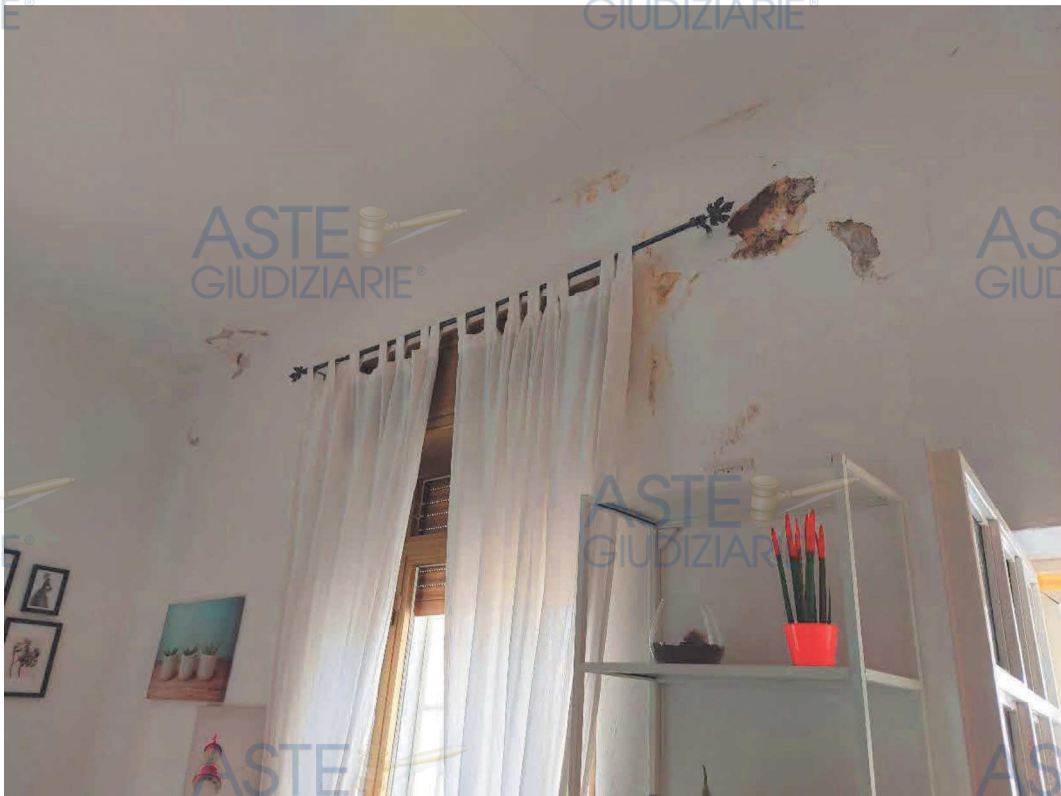
Cucina - Tracce fenomeni infiltrativi
