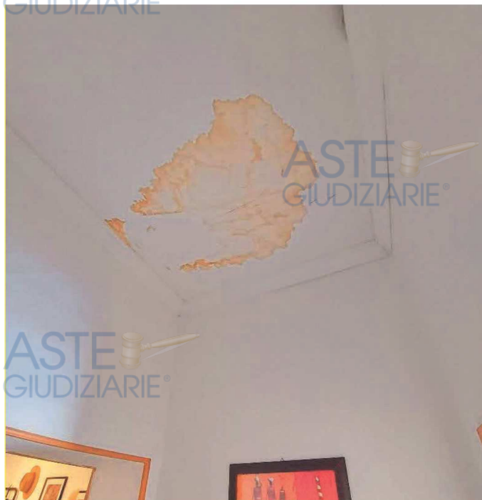
Disimpegno - Tracce fenomeni infiltrativi
