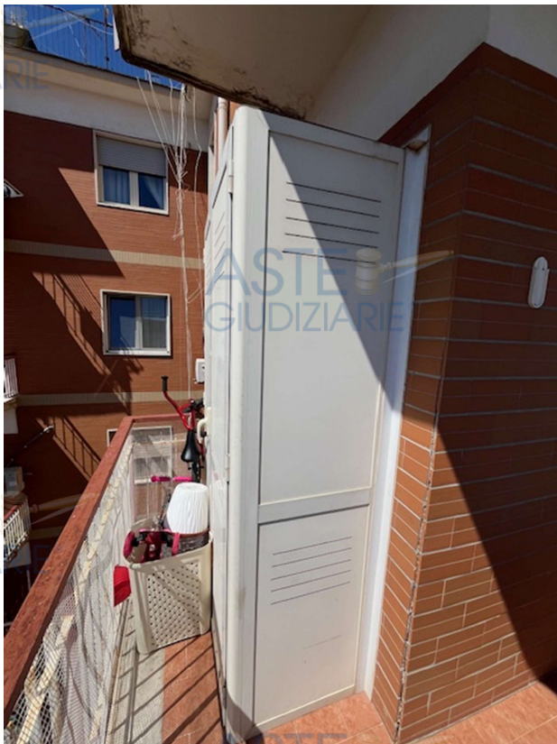
Foto 20. Balcone con mobile in alluminio che non costituisce cubatura
