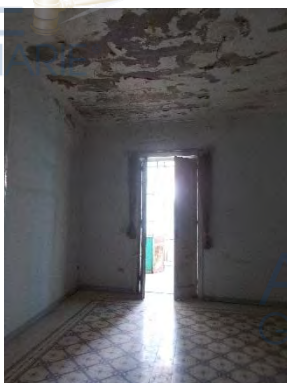
Soffitto della seconda camera
