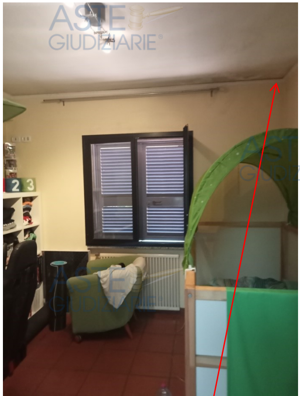
particolare di macchie di condensa
