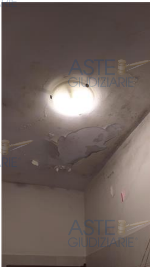
QUADRO DI DEGRADO 1: SOFFITTO LOCALE BAGNO
