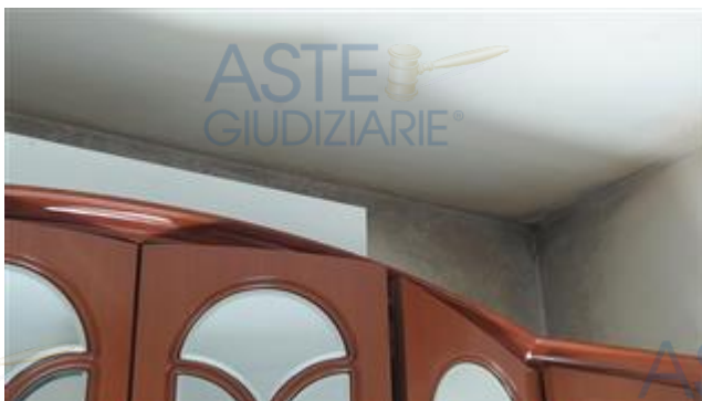
QUADRO DI DEGRADO 4: MUFFA NEL LOCALE CAMERA
