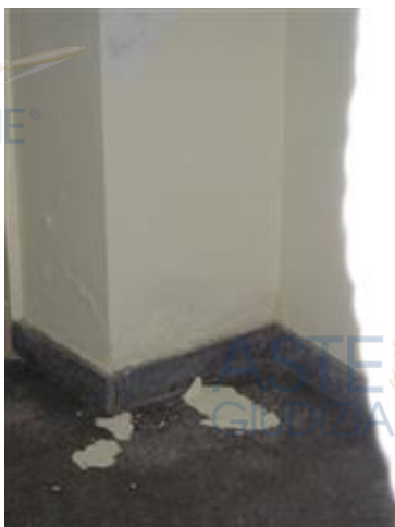
QUADRO DI DEGRADO 3: INFILTRAZIONI SCALE E PIANEROTTOLO COMUNI
