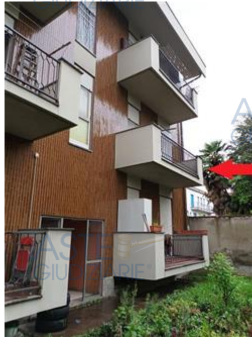
differtà rilevata del balcone
