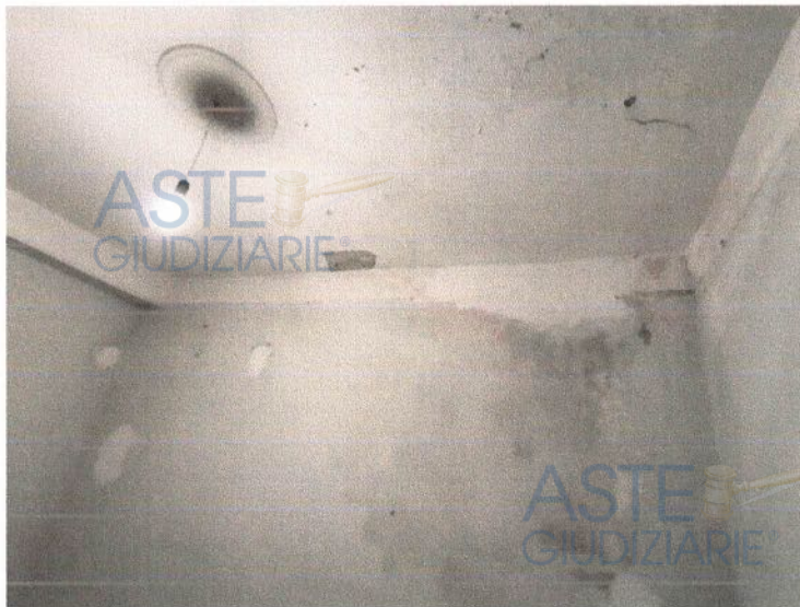
I distacchi di intonaco
