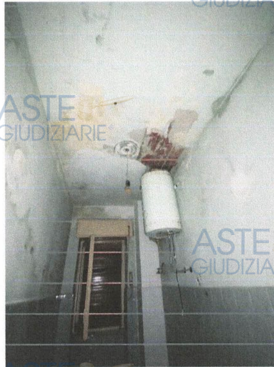
Lo stato delle pareti in bagno
