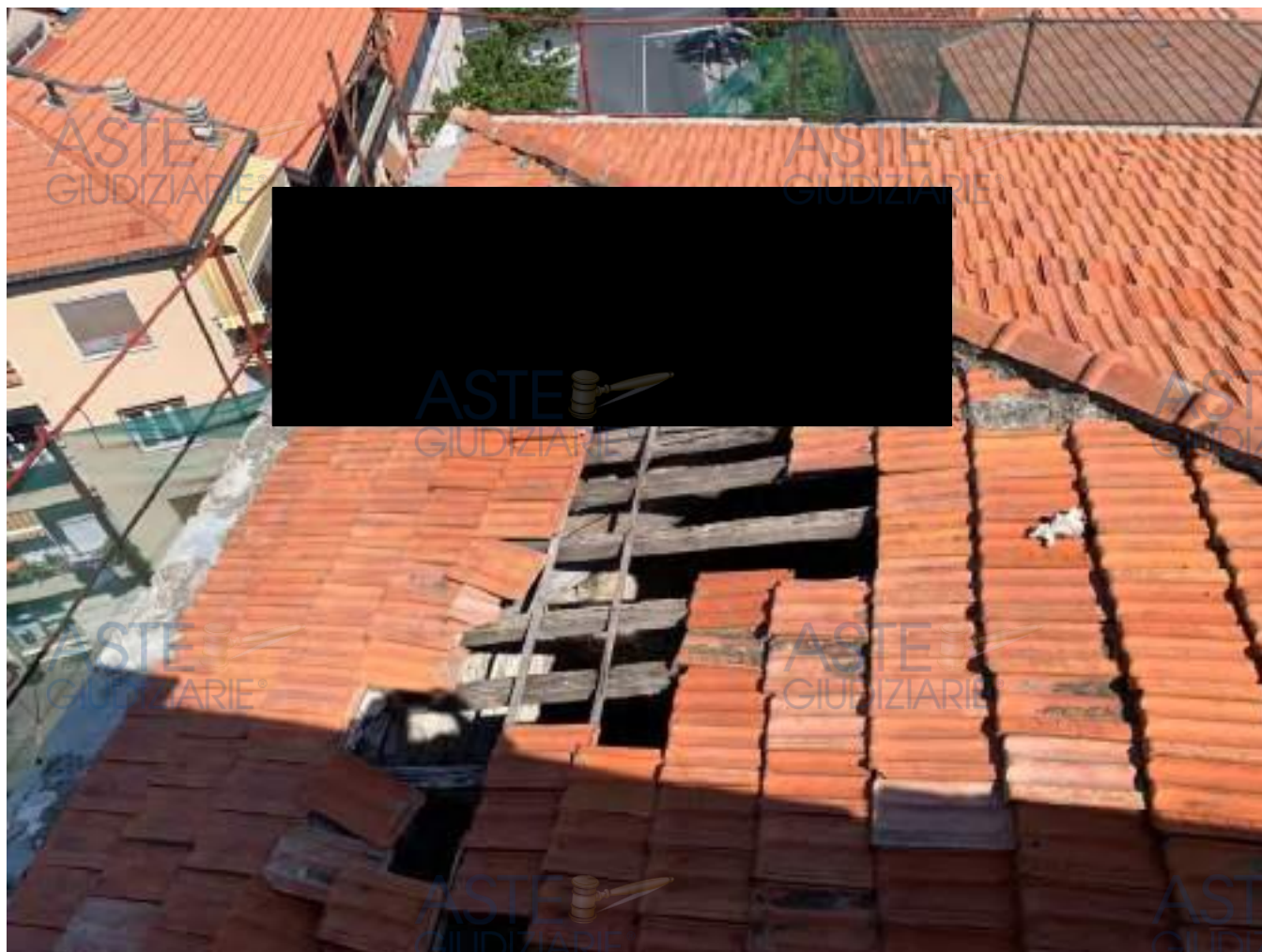
FOTO n° 14 - LA FOTO MOSTRA IL CROLLO DI PARTE DEL TETTO , LATO NORD
