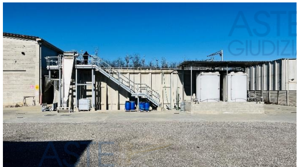
Edificio I – Impianto di depurazione
