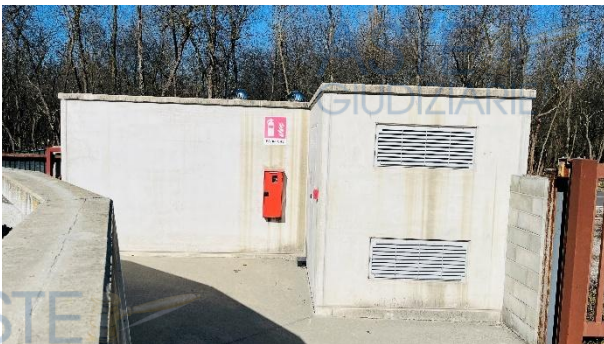
Edificio L – Cabina elettrica
