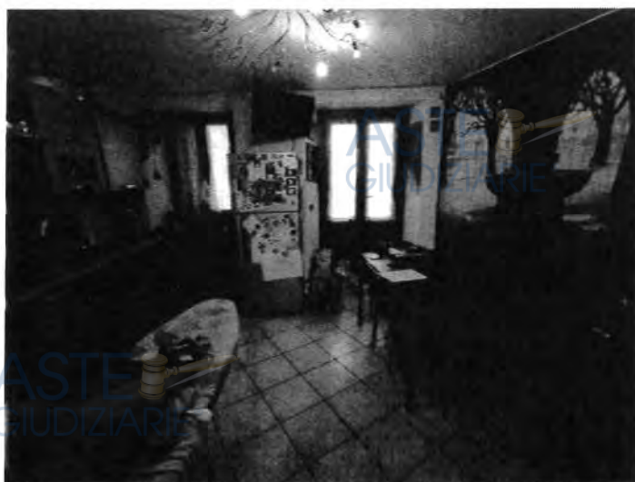
Foto 3: vano al 1°p. attualmente adibito a cucina privo dei requisiti igienico-sanitari
