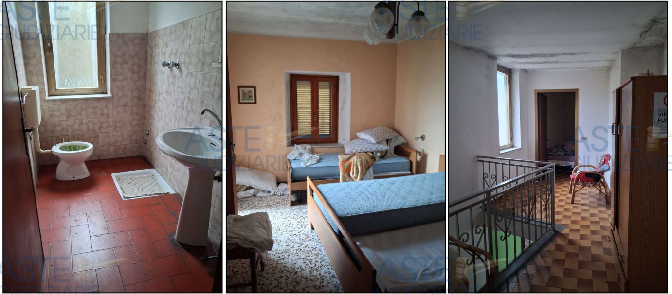
Viste interne di un servizio igienico, una camera da letto e disimpegno dell'albergo.
