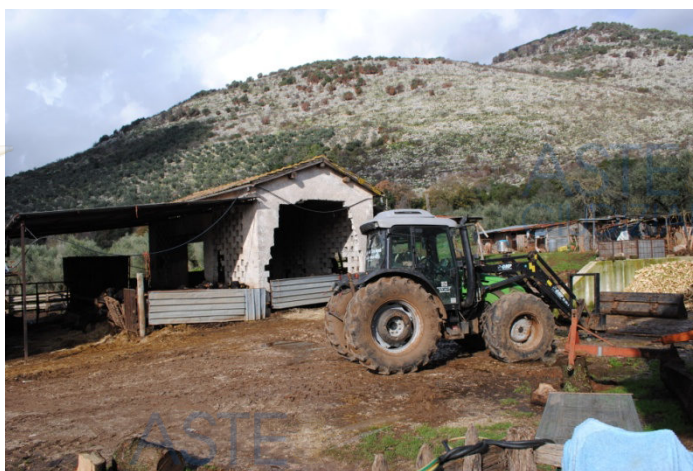
Figura 6. Il fabbricato fatiscente adibito a vitellaia
