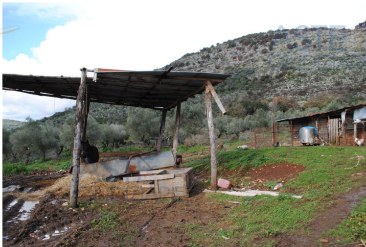
Figura 7. Una delle tettoie in precarie condizioni
