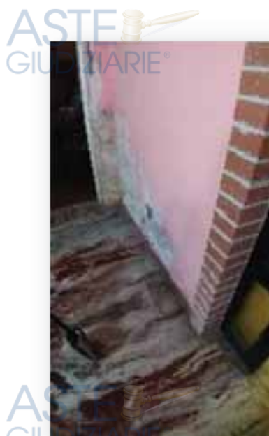
Foto 102 – Umidita di risalita
