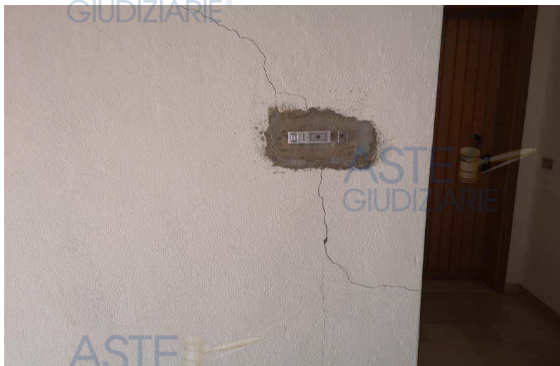
Uno dei fessurimetri posizionati nel vano scale civico n.8
