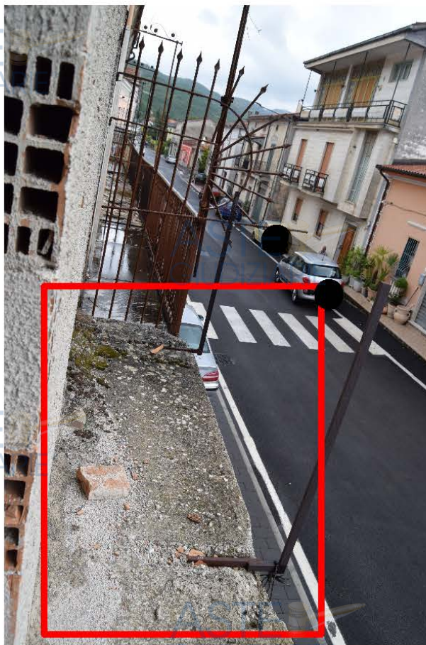
Stato del balcone
