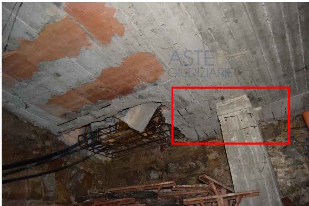
Assenza di copriferro: armatura della struttura ossidata
