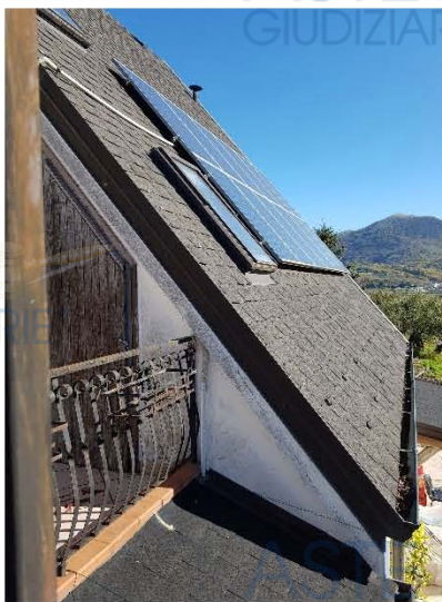
Foto 33 Particolare Tetto con impianto FV e Pensilina di protezione ingresso
