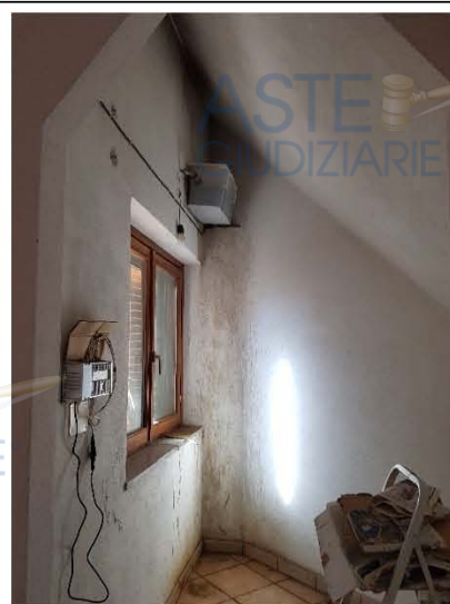
Foto 40 Partic. Quadro impianto FV
