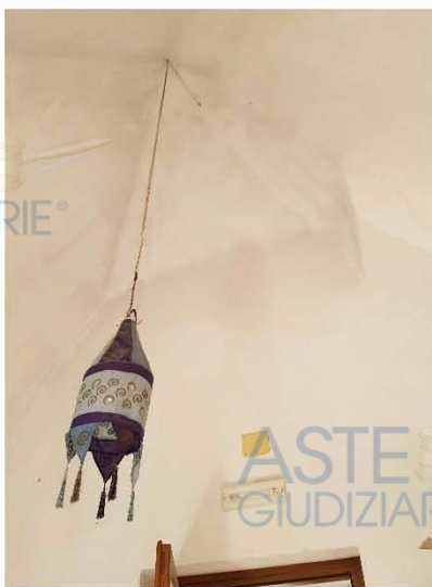
Foto 30 Particolare soffitto Camera C2 - P1
