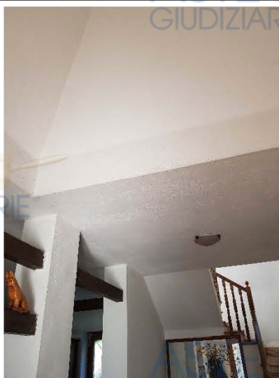
Foto 7 Particolate soffitto Ingresso
