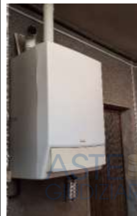
Foto 37 Particolare caldaia P. Semint.
