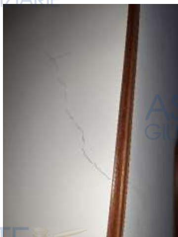
Foto 19 Camera 1- Particolare: Lesione superficiale tramezzo
