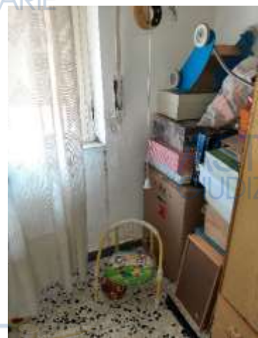
Foto 21 Camera 3 – Particolare: Tracce di umidità da infiltrazione
