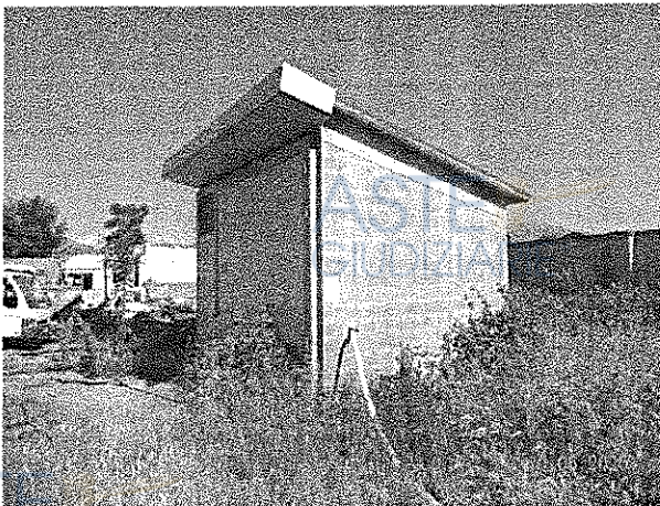
Locale pompe antincendio
