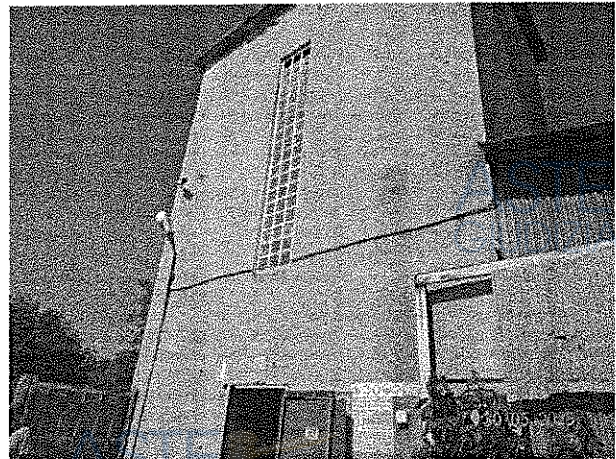
Locale cabina elettrica
