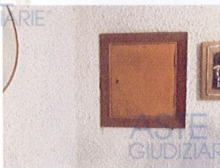
Vano contatore Enel
