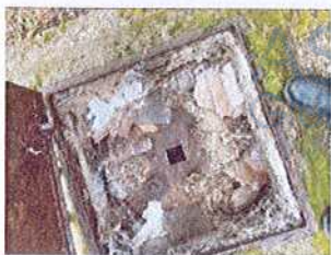
Foro praticato sul serbatoio gasolio
