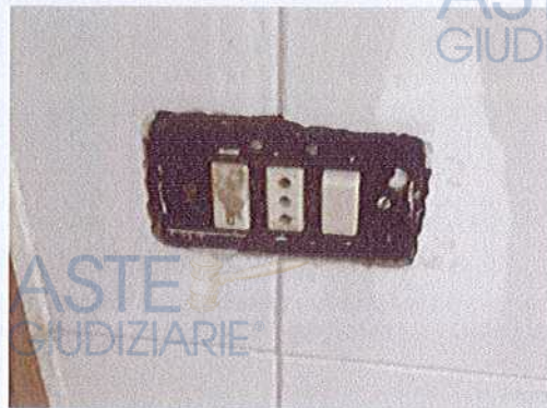
Prese ed interruttori piano sottotetto
