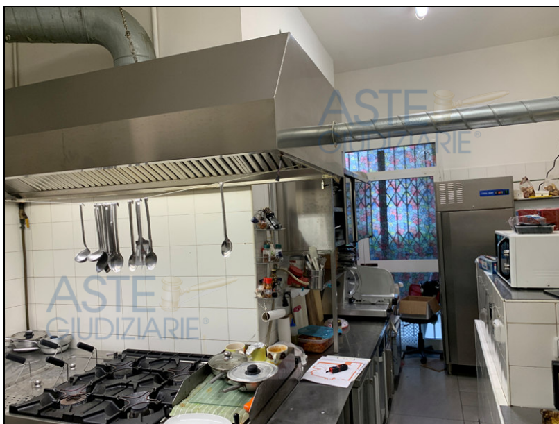
La cucina è un locale di servizio al quale si può accedere anche dalla corte comune, ha le pareti e pavimenti in gres e ha un'apertura, oggi coperta, che affaccia sul banco del bar.
