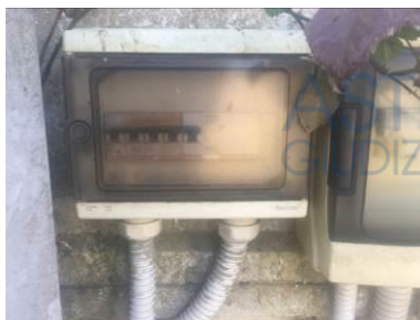
Quadro elettrico trifase
