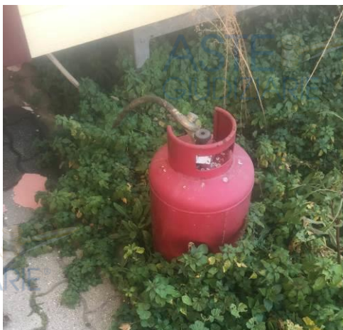
Bombola GPL collegata alla casa mobile
