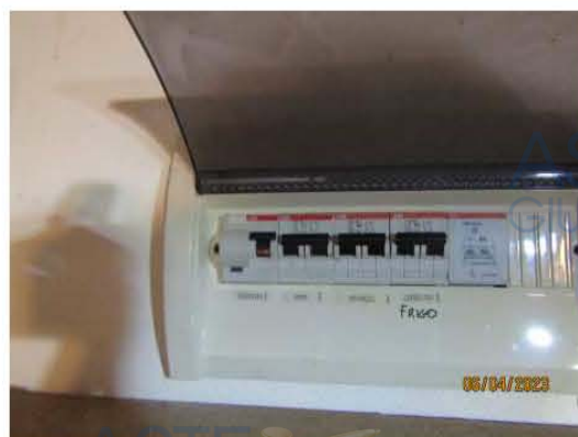
Quadro elettrico cucina
