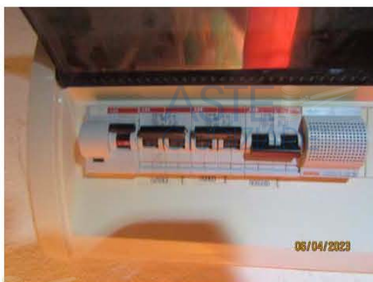
Quadro elettrico piano terra
