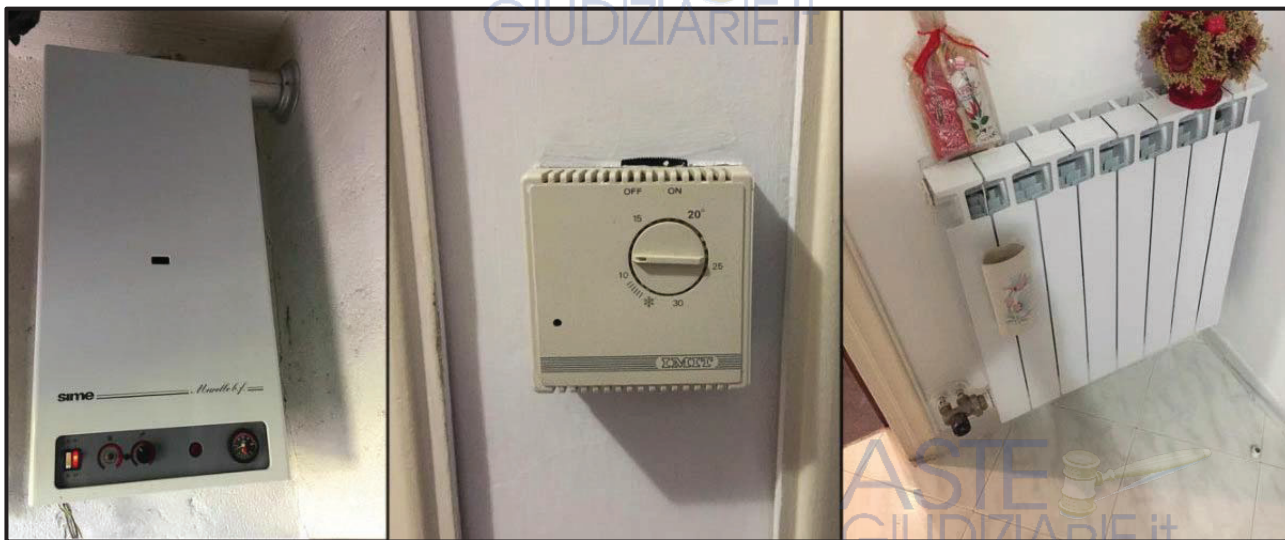
Impianto riscaldamento: caldaia, termostato e radiatore
