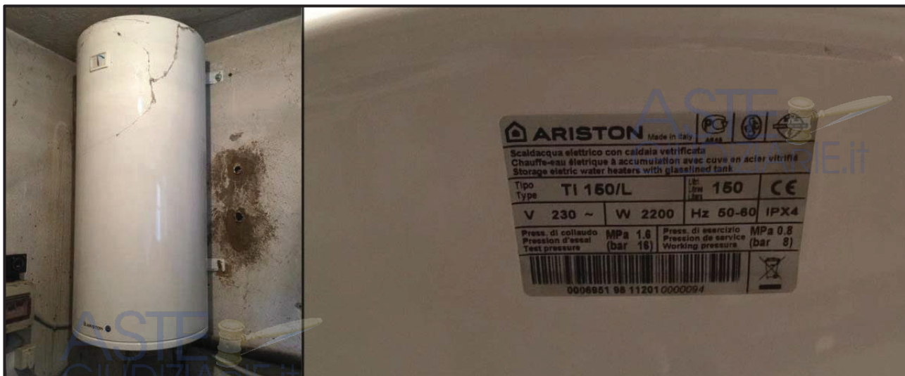
Produzione acqua calda sanitaria
