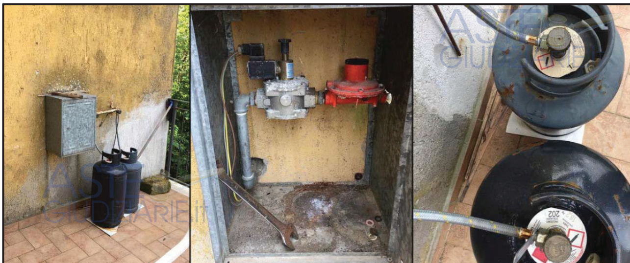
Impianto gas: vecchio alloggiamento contatore e bombole gas GPL
