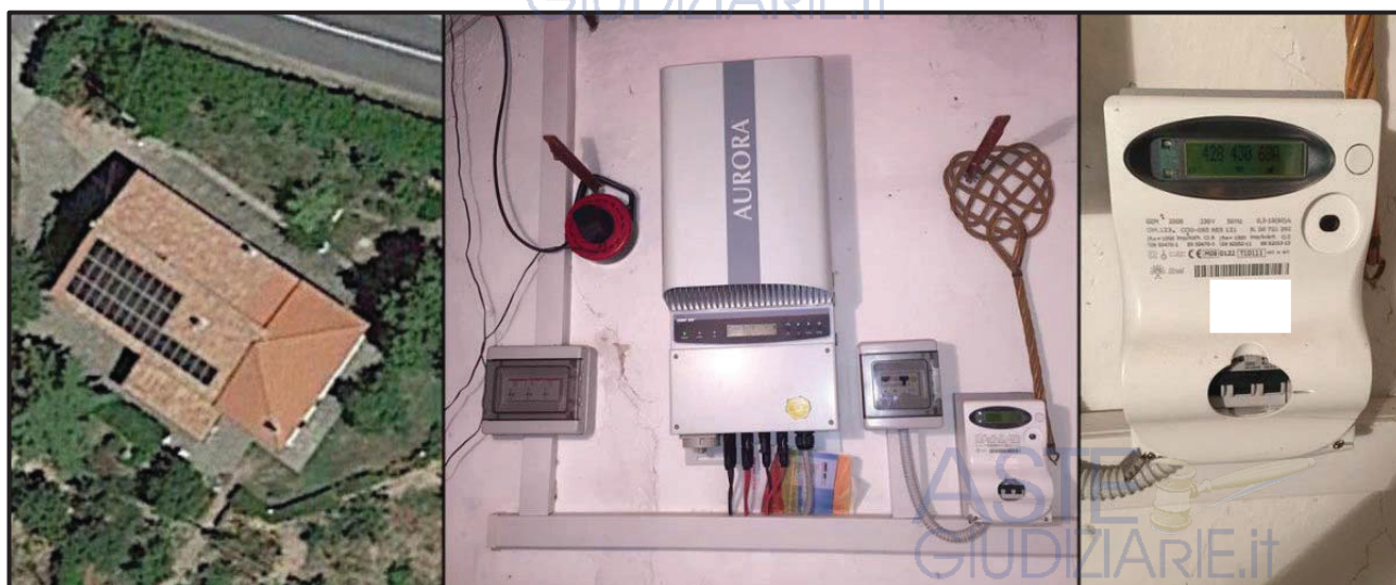
Impianto fotovoltaico: moduli, inverter, contatore di produzione
