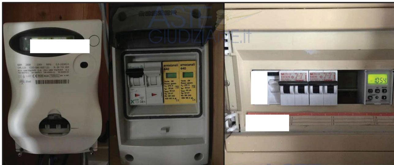
Impianto elettrico: contatore e quadretti elettrici
