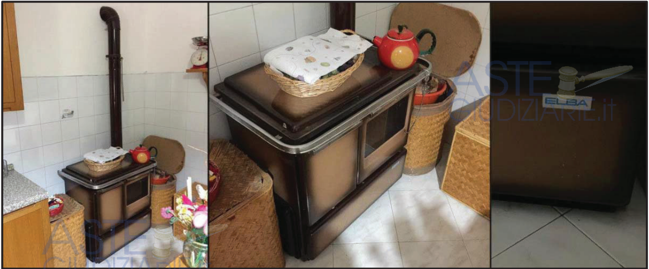
Impianto riscaldamento: termocucina nella zona giorno
