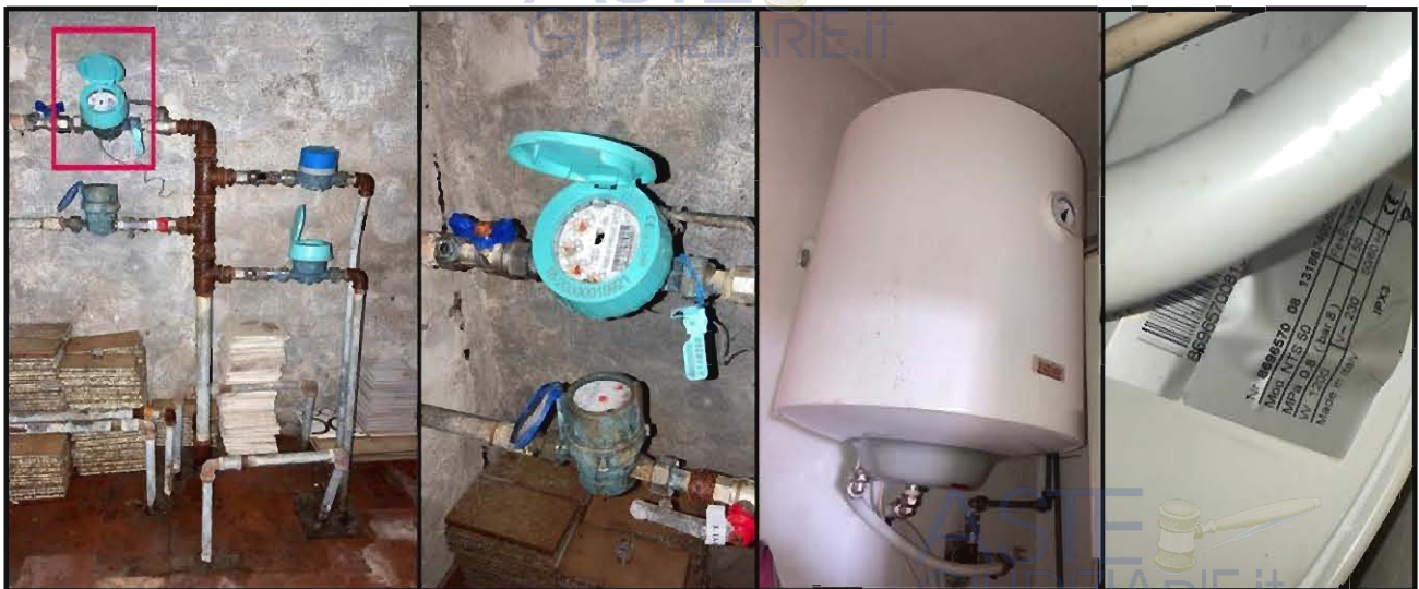
Impianto idrico: contatore in locale comune sottoscala e boiler per ACS
