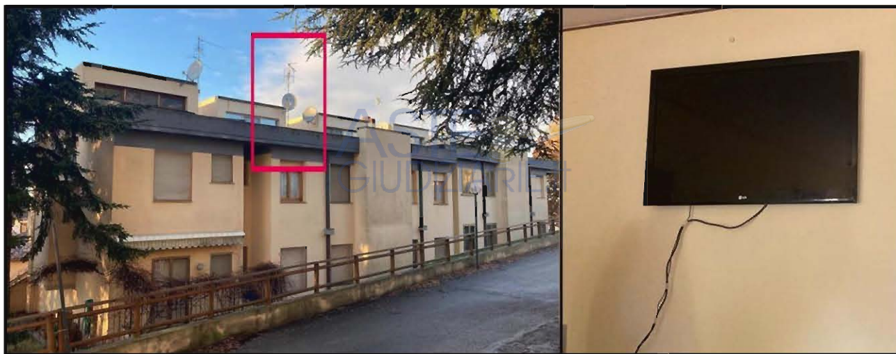
Impianto radio-televisivo: antenna e parabole in copertura, apparecchio tv in unità residenziale
