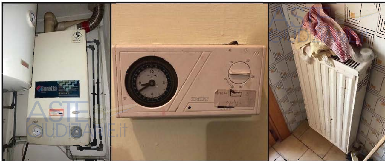
Impianto riscaldamento (disattivato): caldaia, termostato, radiatore.
