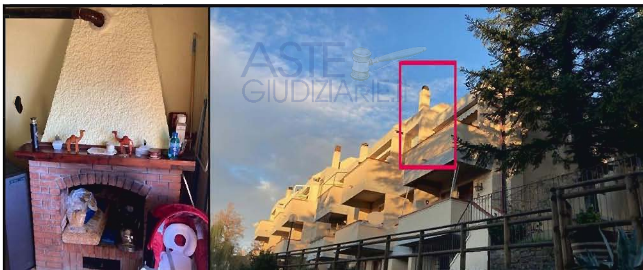
Impianto riscaldamento: camino a legna e canna fumaria
