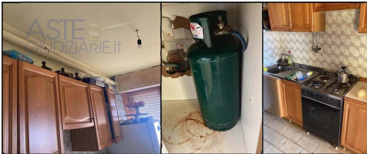
Impianto gas: espulsione fumi caldaia (disattiva), bombola GPL e piano cottura
