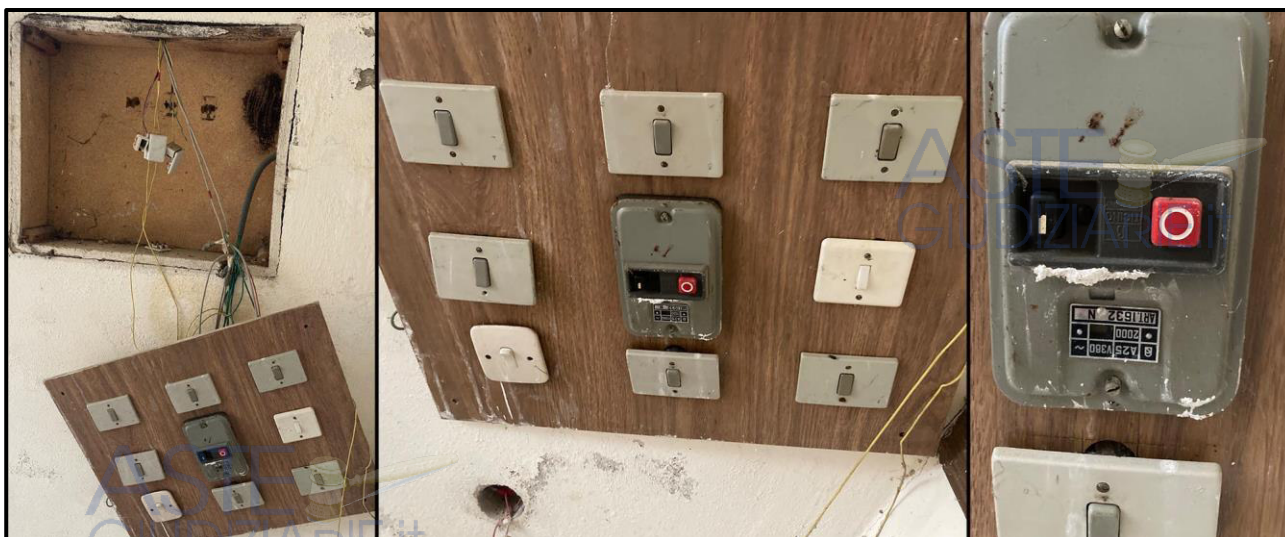
Impianto elettrico: dettagli
