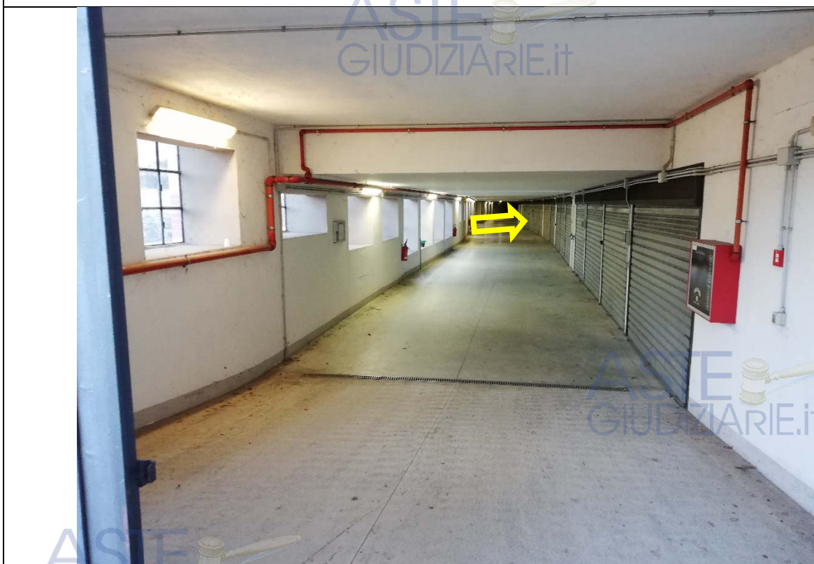
Corsia di manovra principale
