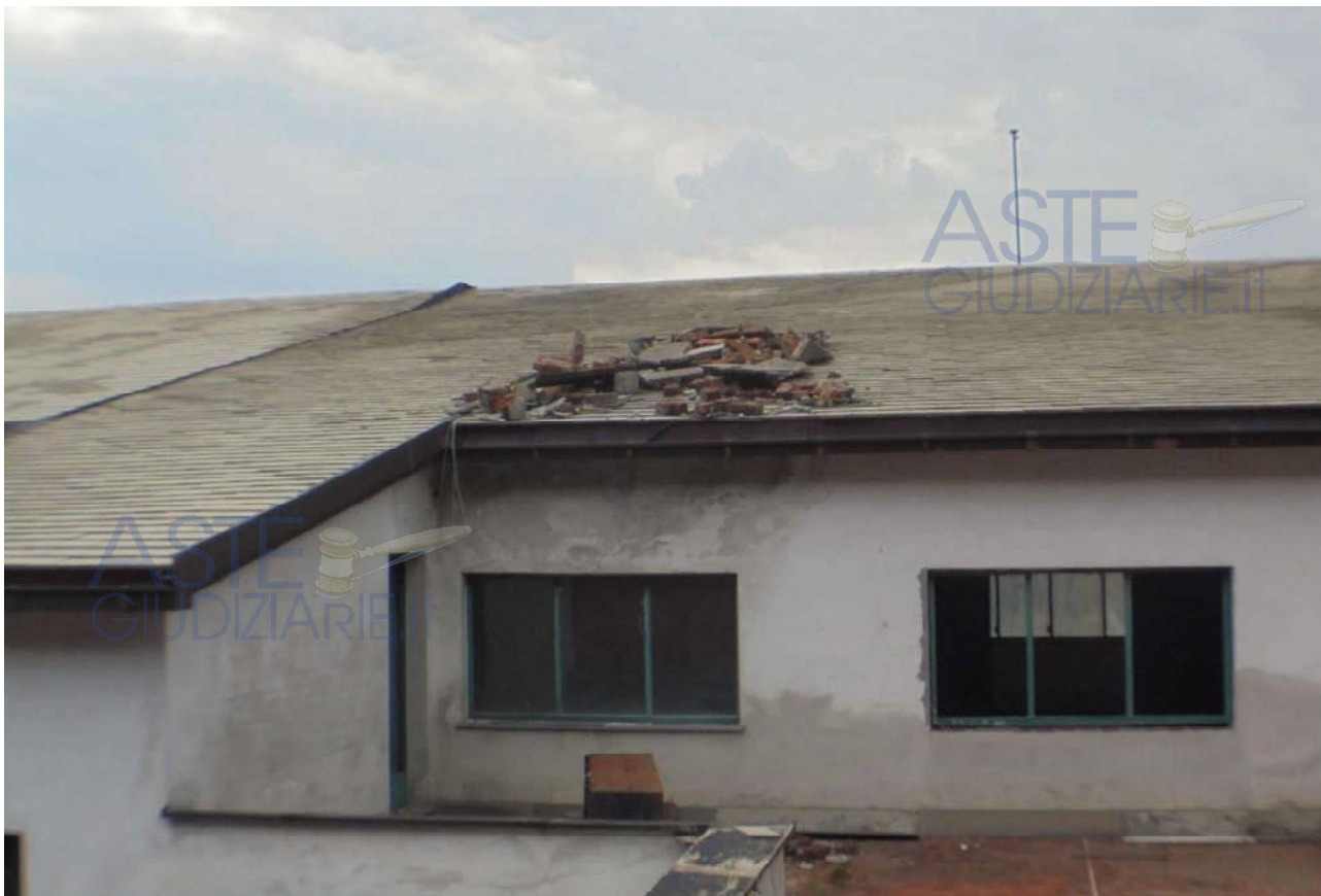
Foto 58 – Dettaglio della porzione del tetto distrutto
