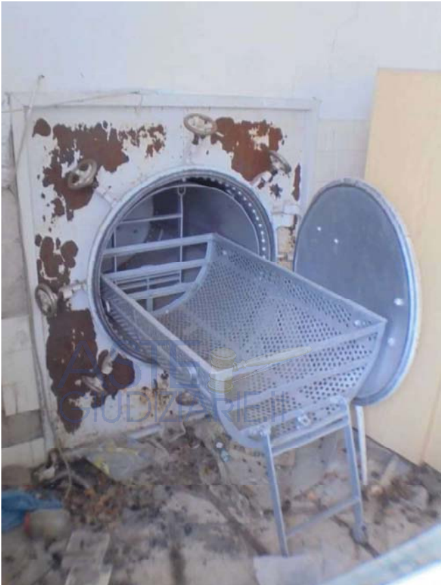
Foto 87 – Dettaglio della “macchina lavatrice” posizionata al 1° piano dell’Edificio 2
