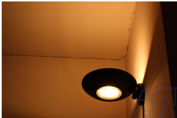
PARTICOLARE LESIONE DEL SOLAIO\SOFFITTO CON LE MURATURE ESTERNE ED INTERNE
