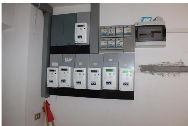
VANO CONTATORI ENEL
