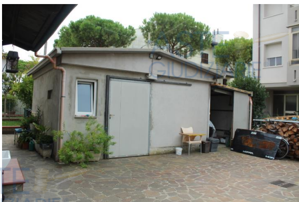
CORPO STACCATO OVE POSTA L'AUTORIMESSA (con portone di accesso eliminato, sostituito da muratura) MANUFATTO ABUSIVO DA DEMOLIRE A DESTRA e BCC SUB 4 A SINISTRA
