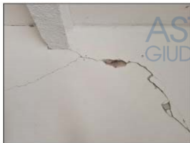
FOTO 118 - LOTTO D Crepe e fessurazioni interne abitazione
