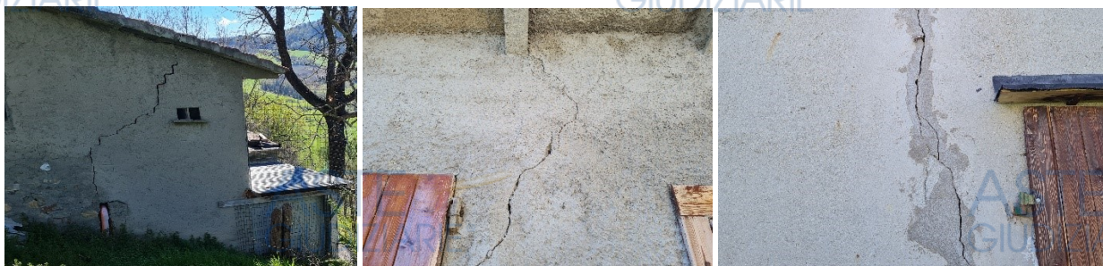
ASSESTAMENTI STRUTTURALI SUI SERVIZI STACCATI
