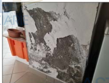
FOTO 56 - LOTTO B Infiltrazioni e umidità da risalita
