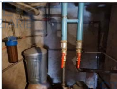
FOTO 62 - LOTTO B Impianti centrale termica
