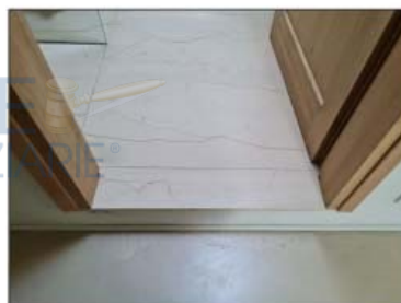
FOTO 35 - LOTTO C Dettaglio pavimento bagno
