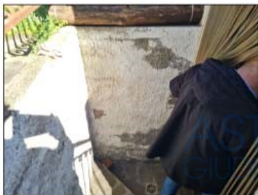
FOTO 58 - LOTTO B e C Umidità scala cantina
