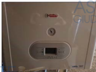
FOTO 61 - LOTTO B Caldaia riscaldamento e ACS
