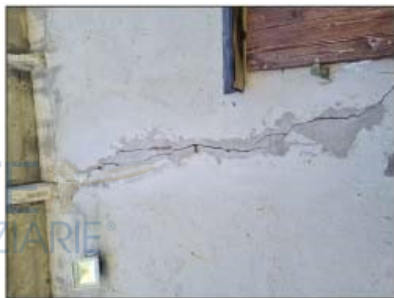
FOTO 98 - LOTTO D Crepe e fessurazioni deposito esterno
