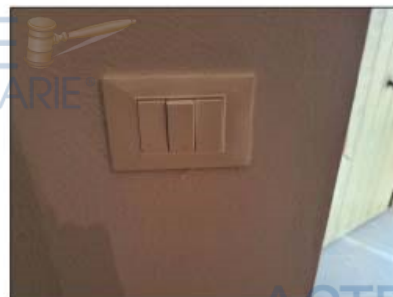
FOTO 114 - LOTTO D Impianto elettrico
