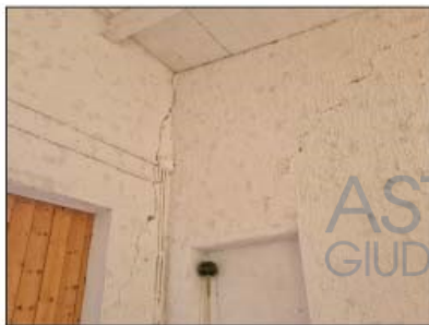
FOTO 97 - LOTTO D Crepe e fessurazioni deposito esterno
