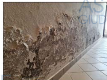
FOTO 57 - LOTTO B Infiltrazioni e umidità da risalita
