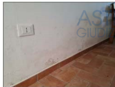
FOTO 120 - LOTTO D Umidità di risalita nei muri
