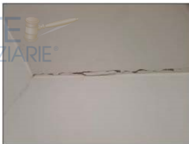
FOTO 119 - LOTTO D Crepe e fessurazioni interne abitazione
