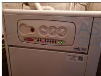
FOTO 37 - LOTTO C Caldaia riscaldamento e ACS
