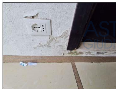
FOTO 99 - UMIDITA' DA RISALITA
