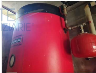
FOTO 53 - ACCUMULO ACQUA CALDA
