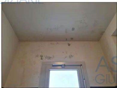
FOTO 100 - INFILTRAZIONI E MUFFE
