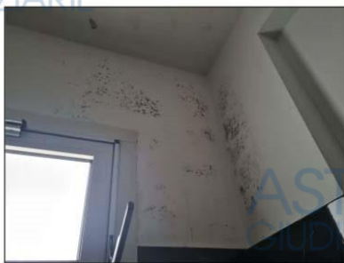
FOTO 102 - INFILTRAZIONI E MUFFE
