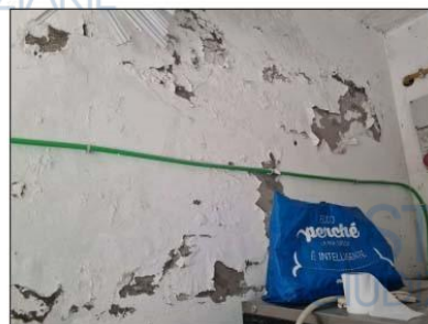
FOTO 105 - UMIDITA' E INFILTRAZIONI
