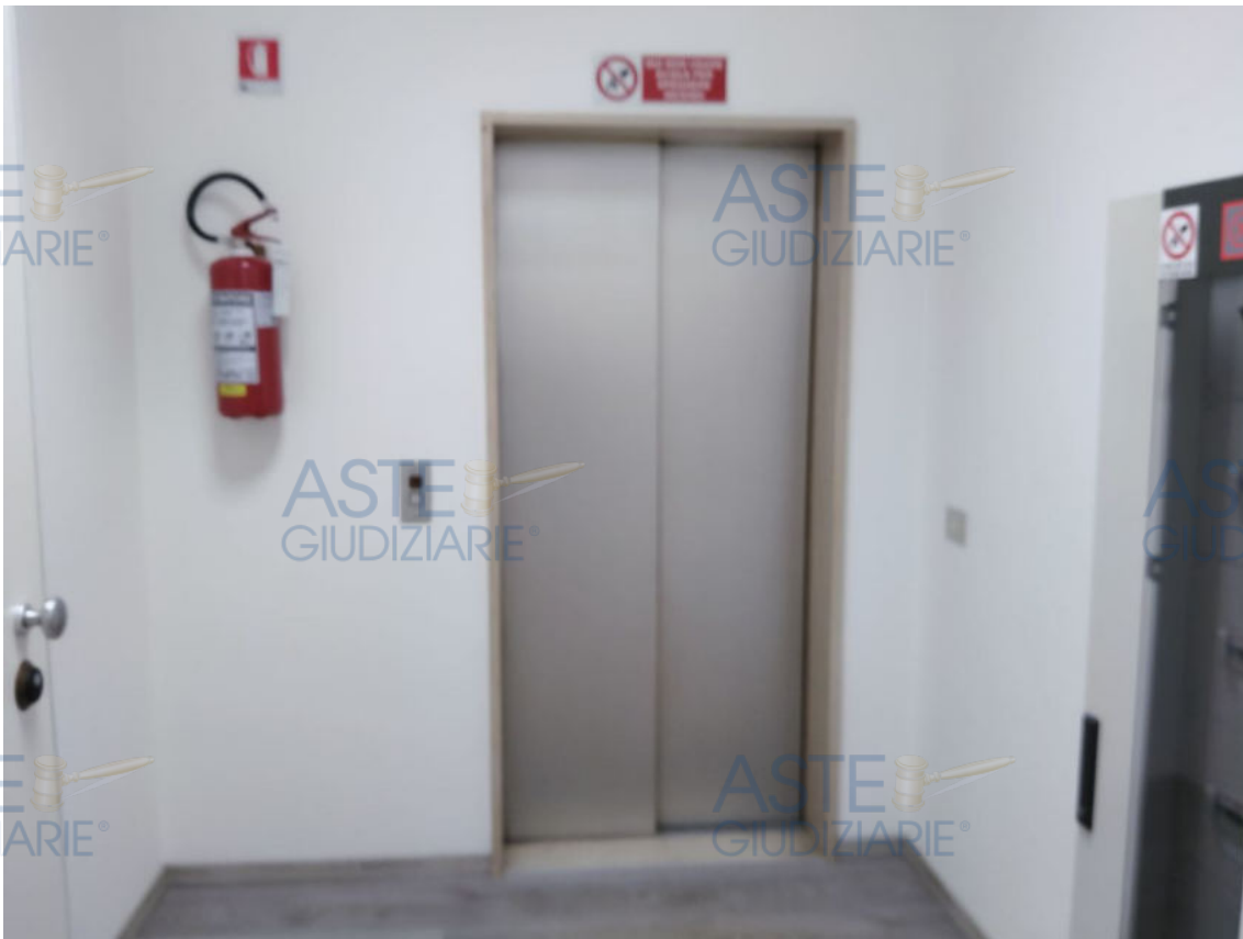
Fot.4 – Vista dell'ascensore dell'edificio.
