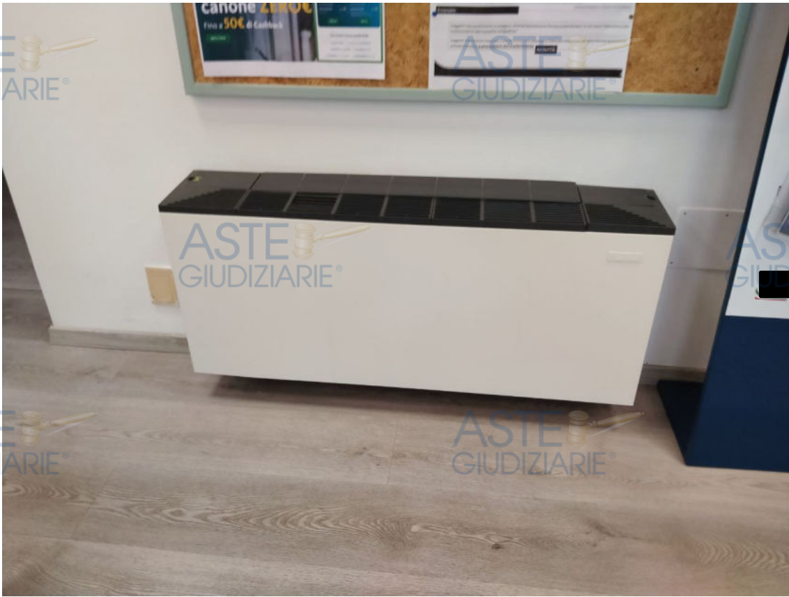
Fot.13 – Vista dei ventilconvettori
