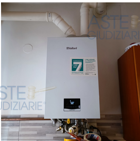
caldaia per riscaldamento e ACS, garage
