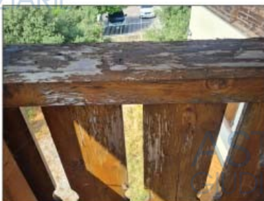
FOTO 77 - PARAPETTO IN LEGNO USURATO
