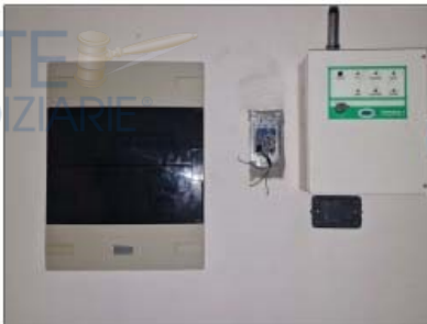
FOTO 67 - QUADRO ELETTRICO E IMPIANTI
