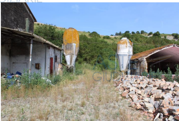
CORTE POSTA FRA CASA COLONICA E ALLEVAMENTO CORPO 2, CROLLATO
