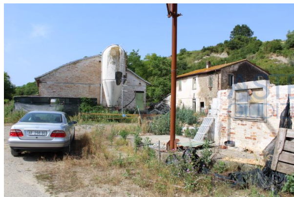
FABBRICATI VISTI DALLA STRADA; ALLEVAMENTO CORPO 1, ABITAZIONE COLONICA E A DESTRA ALLEVAMENTO CORPO 2, CROLLATO
