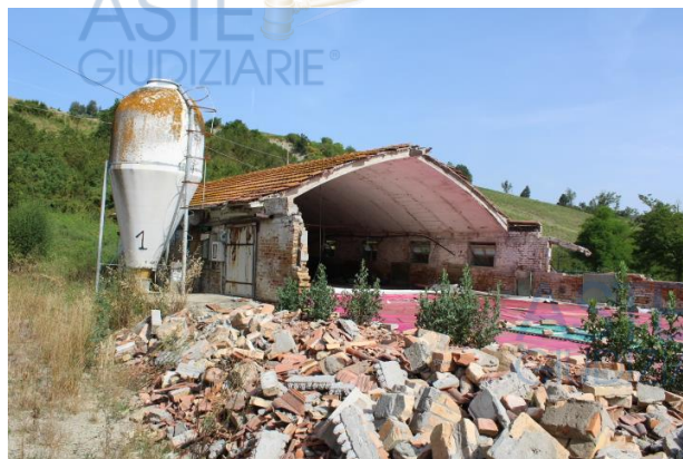
PARTICOLARE CUMULO DI MACERIE, ALLEVAMENTO CORPO 2, DA SMALTIRE IN DISCARICA AUTORIZZATA
