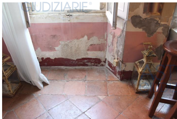
PARTI E COLARE DEGLI AMMALORAMENTI MURARI
