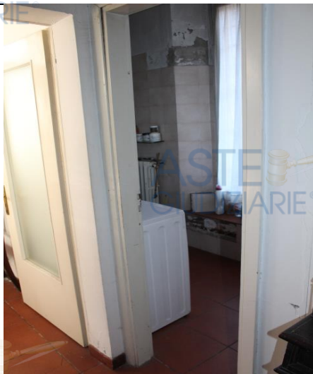
BAGNO – SI NOTANO SEGNI DI UMIDITA'
