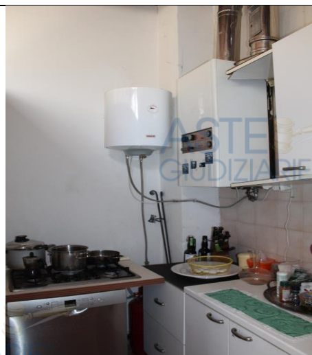
CUCINA; PARTICOLARE BOILER E CALDAIA NON FUNZIONANTE
