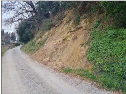
FOTO 23 - VIA DUGARIA SCARPATE
