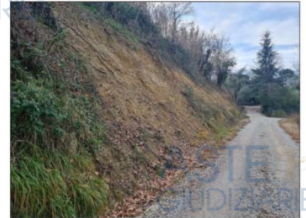
FOTO 25 - SCARPATE A RISCHIO FRANA
