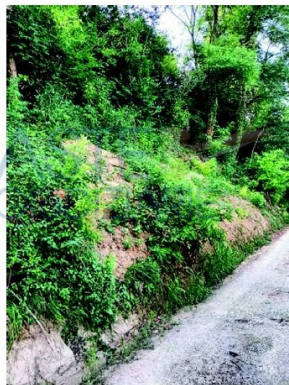
Foto 17: particolare della scarpata in dissesto.
