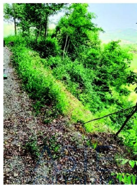
Foto 8: Scarpata in dissesto lato valle punto 12.
