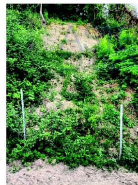
Foto 15: scarpata in dissesto a valle del punto 12.
