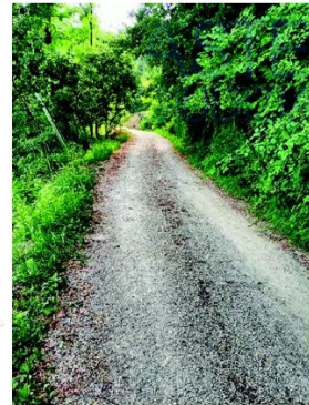
Foto 9: Alberature e palo luce inclinati sul lato valle.
