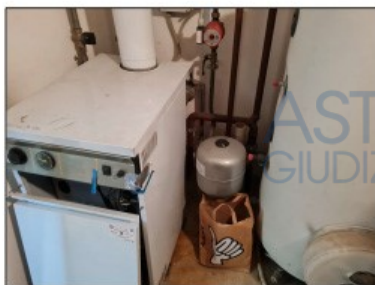
FOTO 98 - CALDAIA TRADIZIONALE MARCA RIELLO
