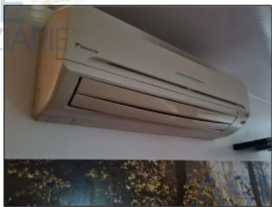
FOTO 100 - SPLIT RAFFRESCAMENTO INTERNO MARCA DAIKIN
