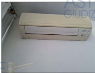
FOTO 101 - SPLIT RAFFRESCAMENTO INTERNO MARCA DAIKIN
