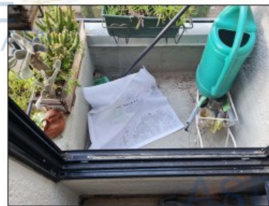
FOTO 27 - VERANDA NON CONFORME
