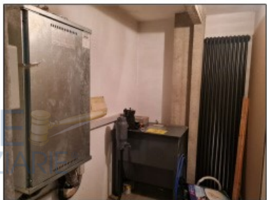
FOTO 94 - SALA MACCHINE ASCENSORE
