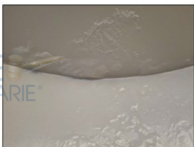
FOTO 114 - INFILTRAZIONE SOFFITTO E PARETE PIANO SECONDO
