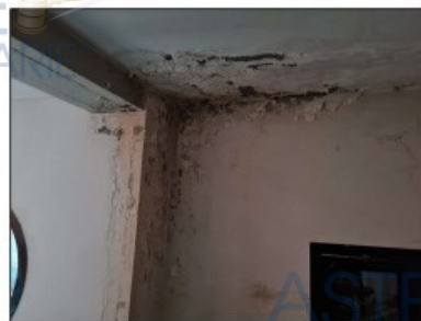
FOTO 111 - INFILTRAZIONE A PIANO INTERRATO
