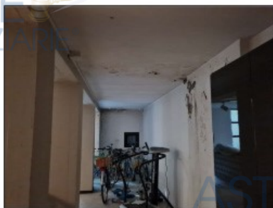
FOTO 109 - INFILTRAZIONE A PIANO INTERRATO
