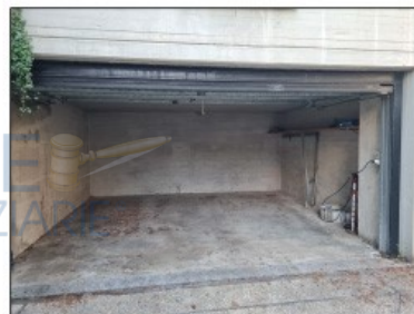
FOTO 21 - AUTORIMESSA NON CONFORME
