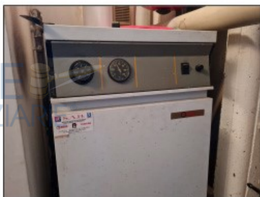
FOTO 97 - CALDAIA TRADIZIONALE MARCA RIELLO
