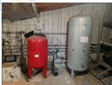
FOTO 44 - IMPIANTI VANO SOTTO RAMPA CARRABILE
