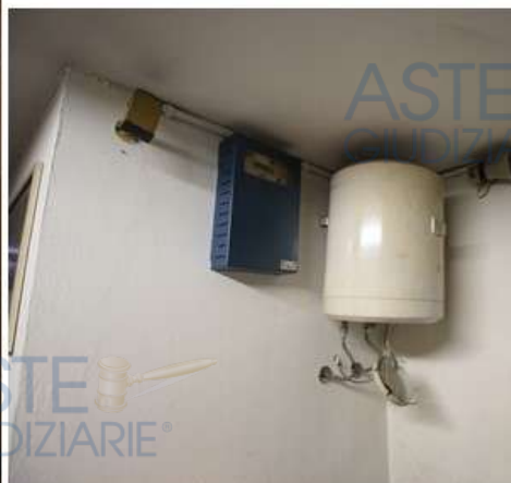
Foto 15: boiler e allarme posti accanto al bagno
